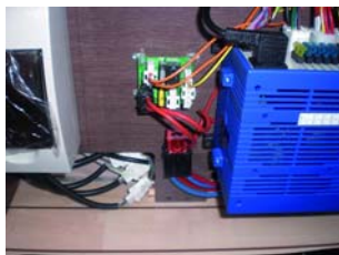
Porte fusibles et module fusible relais
